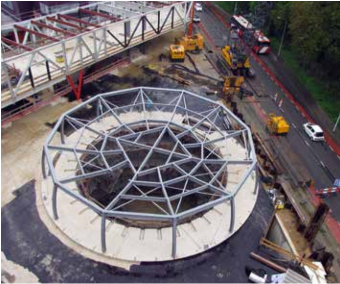
Auditoriumvloer. De basisspanen doen hun werk, want de binnenring is nog niet gesloten.
