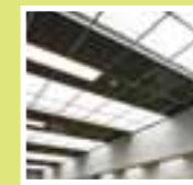
glazen dak van het atrium zorgt voor licht maar houdt warmte buiten
